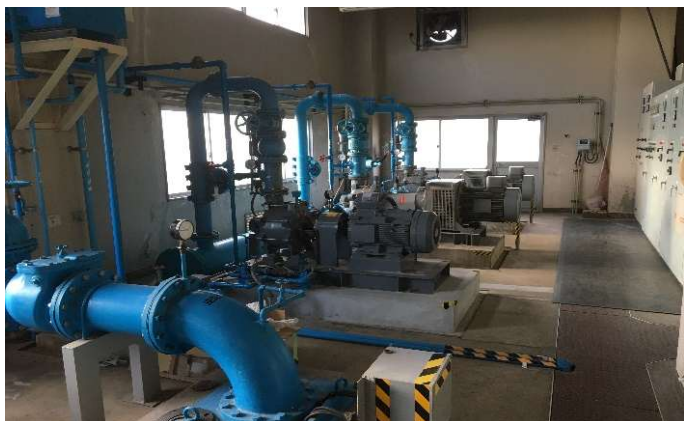
■ 配水ポンプ設備
