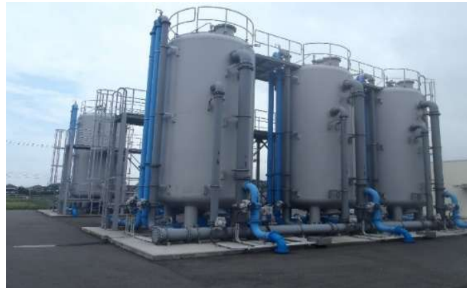
■ 平成26年度に完成した粒状活性炭処理施設
