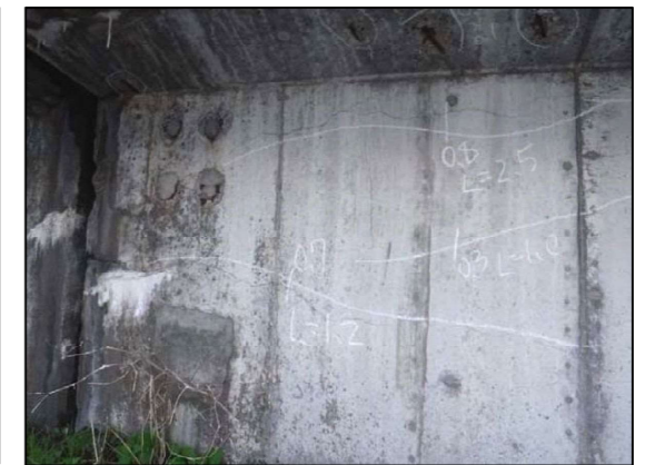
PC 側面のひびわれ(2242_寺畔橋) :H30 年度補修
