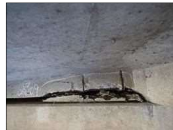
RC 横桁の鉄筋露出(0232_崎野橋)
