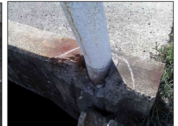
地覆コンクリートの欠損(0121_フシウ橋)
