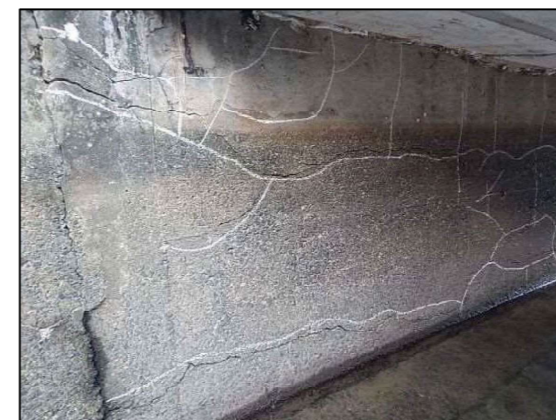
橋台前面でのひびわれ(0122_寺田橋) :調査中
