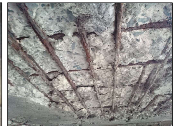
RC 主桁下面の鉄筋露出(0266_下正路中橋) :H30 架替え中
