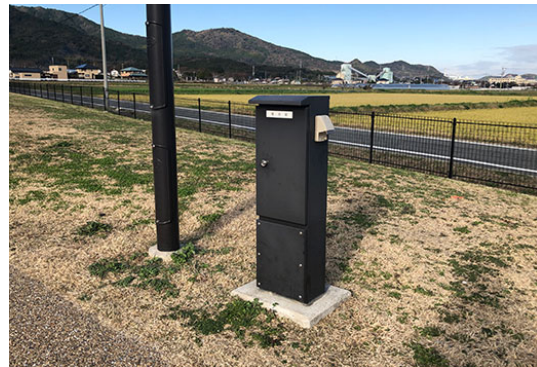
図 8-2-19 電源設備 (吉武高木遺跡 / 福岡市)
