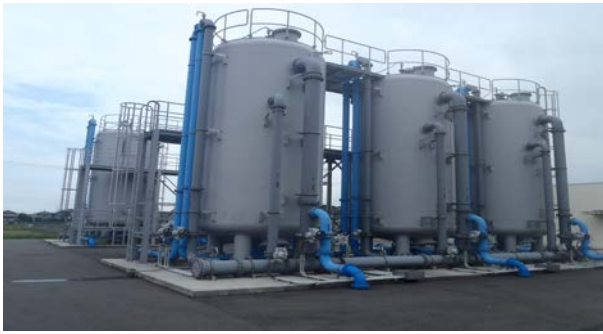
【平成26年度に完成した高度浄水施設】
